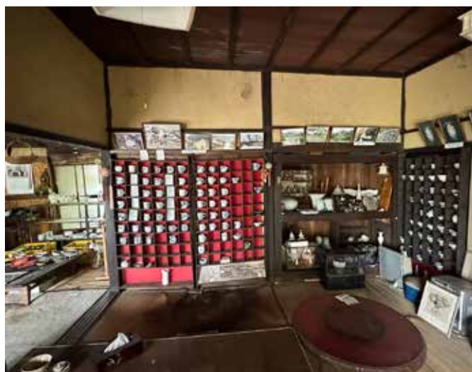
▲ 村の駅五本松の座敷。雨漏りによって床が傷んでいる。
