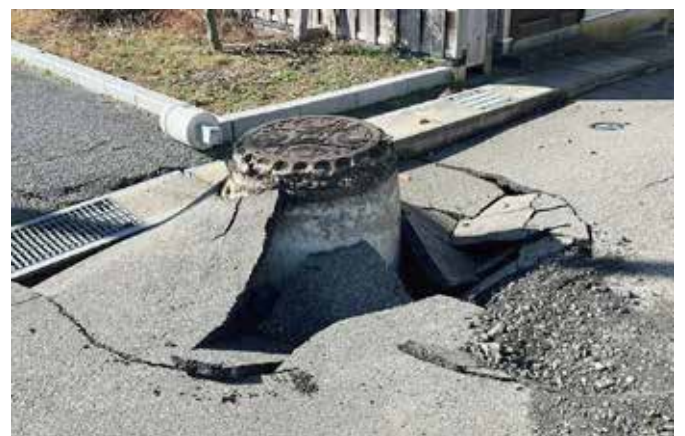
▲路面から飛び出した輪島市のマンホール
